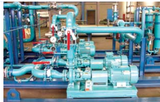
Pumpen- und Filterstation für MEA-Lösung
